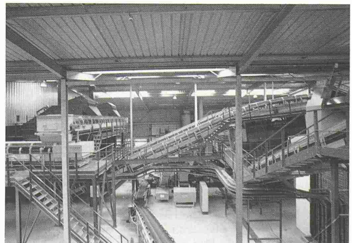
Nach der Annahme wird der Müll sortiert und verkleinert
