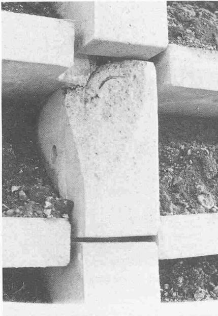
Bild 3. Typischer Binderkopfschaden als Folge einer Überbeanspruchung in der Läufer-Binder-Kraftübertragung
