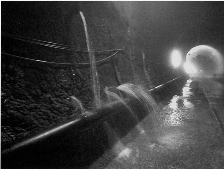
Fig. 1: Ergiebige Bergwasserzutritte in der Weströhre im Bereich des Querschlages 16 während der Schneeschmelze. Bild vom 21.6.2010 bei km 204.735, Blick Richtung Süden.
