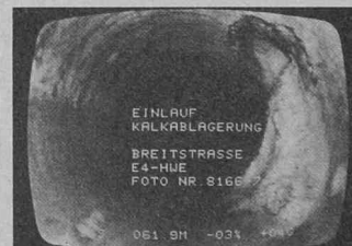
Auf dem Monitor werden Messwerte wie Distanz, Längsgefälle und Querverneigung im Fernsehbild festgehalten
