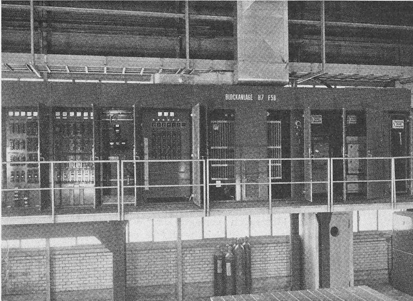
Bild 8. Blockanlage mit geöffneten Türen
