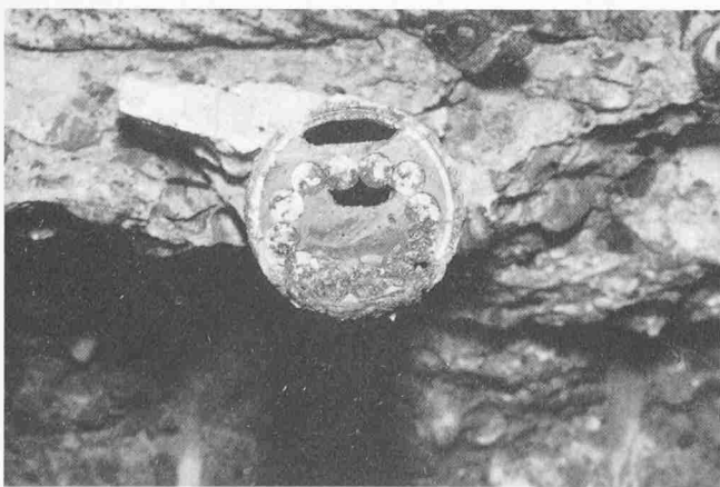
Bild 8. Längskabel im Streifen S2. Schnitt des Kabels direkt vor dem Ankerkopf, Seite Wallisellen. Hohlräume an der Oberseite des Kabels erkennbar Longitudinal cable in strip S2. Section of the cable directly before the anchor head, Wallisellen side. Voids on the upper side of the cable recognisable.
