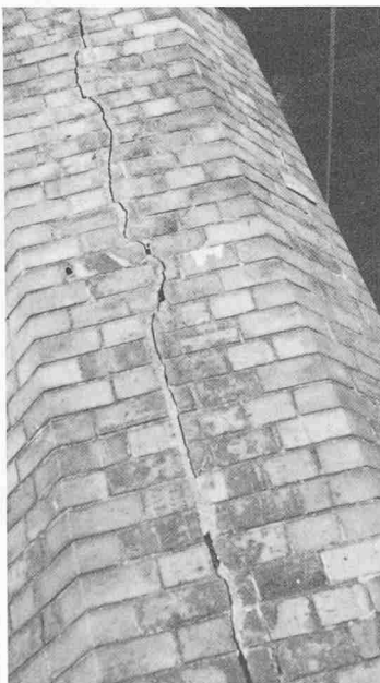
Links: Riss in einem Pfeiler einer Strassenbrücke
