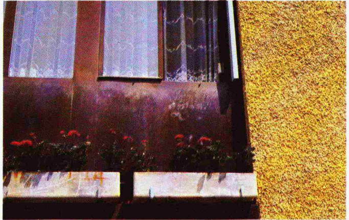
Bild 6. Fassadenelemente in Sandwich-Bauweise mit PUR-Schaumstoff als Wärmedämmung. Perforationen in der Bildmitte
