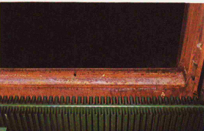
Bild 10. Fensterrahmen nach Osten orientiert mit geringerer Korrosion nach vier Jahren als im vorherigen Bild
