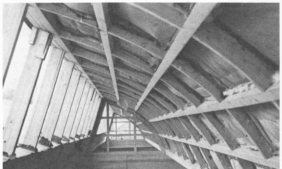
Bild 21. Schalenrost nach E. Staudacher in der Shedkonstruktion einer Industriebaute, 1948. 2 Felder mit je 17 m Stützweite und durchlaufenden Elementen. Jede Shed-Einheit besteht aus einer Rostschale, einem ebenen Rost als Rinnenelement und einem verleimten, ebenen Fensterteil. Ingenieurbüro E. B. Geering, Basel, und Holzbauunternehmungen Osterwald & Bischof, St. Gallen, sowie Gribi & Co. AG, Burgdorf. (Foto EMPA-Holz)
