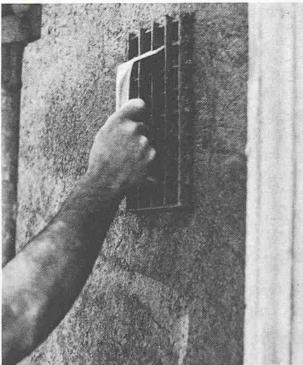
Bild 8. Der Rabot ist eines der möglichen Hilfsmittel, um die Sinterhaut nach dem «Anziehen» des Mörtels zu entfernen
