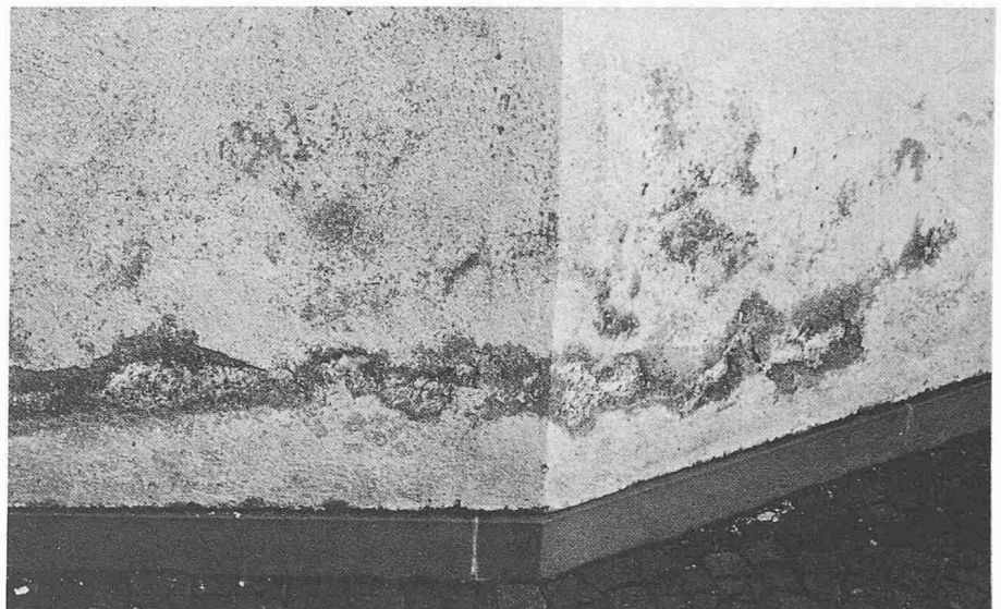
Bild 21. Aus dem Fundament aufsteigende Feuchtigkeit mit gelösten Salzen verursacht über dem stark wasserdampfhemmenden Sockel Schäden mit Ausblühungen
