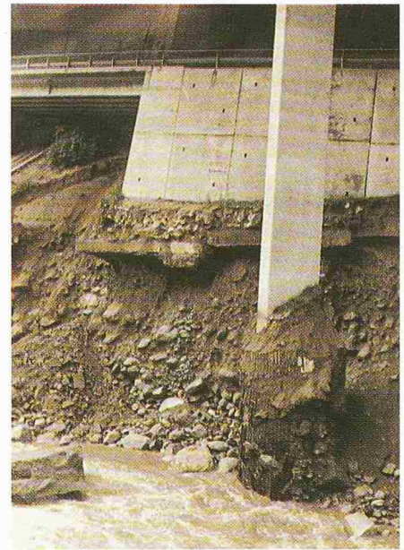
Bild 6. Abgesenkte Schachtfundation, Pfeiler I von Norden und unterspülte Stützmauer/Widerlager Lehnenviadukt Kantonsstrasse Bildautor: T.R. Schneider, 1877/19A
