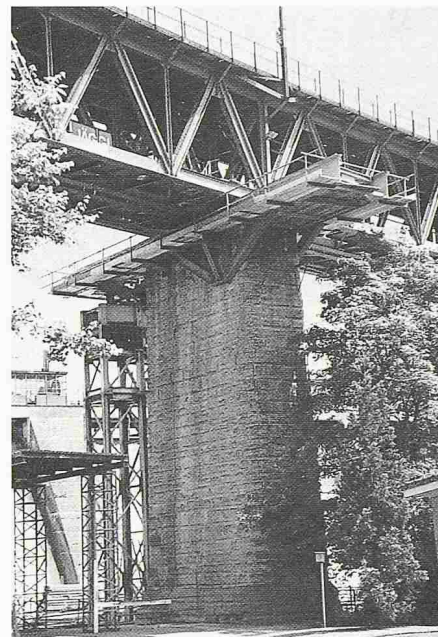
Bild 5. Der Pfeiler auf Seite Wettingen mit fertig installierter Doppelverschubbahn. Abstützung auf Pfeiler und Gerüsturm
