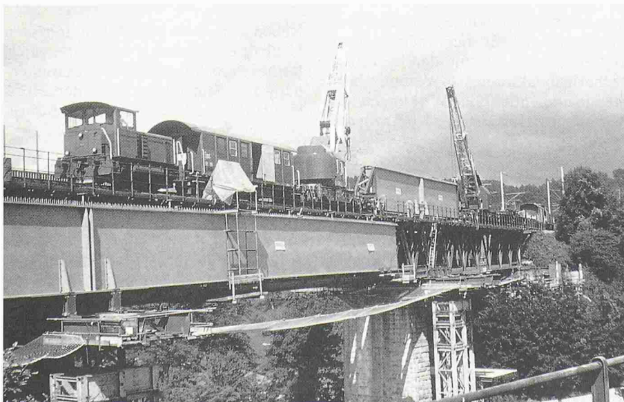
Bild 6. Montagephase der Stahlträger: Bereitgestelltes Trägerpaar, begleitet von zwei Bahnkrangruppen für den Ablad und das seitliche Versetzen neben die alte Brücke
