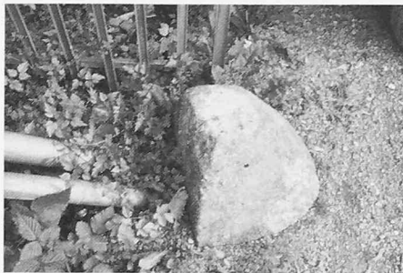
Die Hauptkabel laufen direkt in den Boden hinein, ohne von einem Steinsockel abgelenkt zu werden. Sie sind einzig durch Blechhülsen vor Rost geschützt, die mit Fett ausgepresst sind
