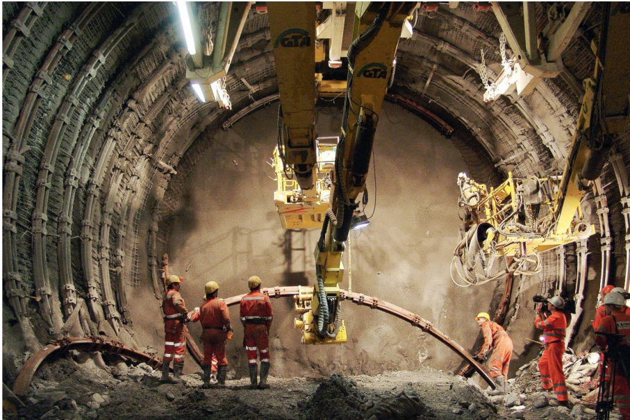
01 Einbau von Stahlbögen an der Tunnelbrüst bei Sedrun (Foto: Alp Transit Gotthard AG)
