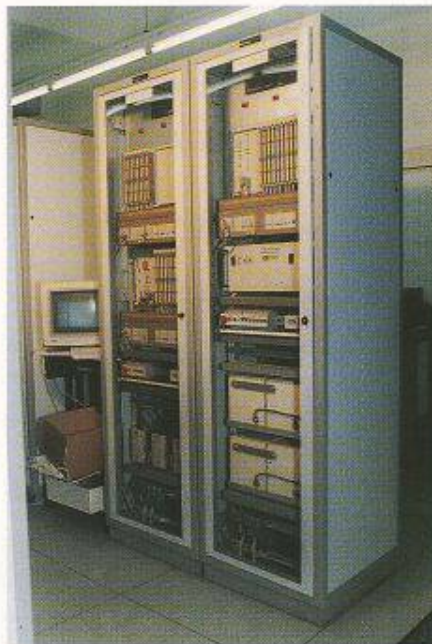
Bild 3. Masterstation Simatic U 155
