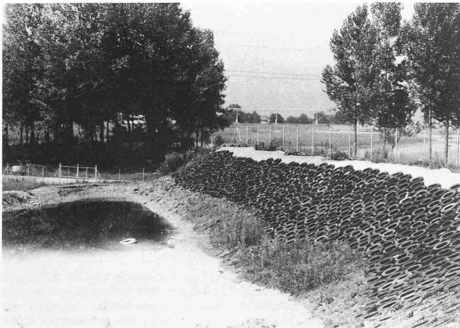
Bild 1. Blick auf die Pilotanlage auf dem Areal der Ciba-Geigy AG in Monthey. Die Böschungen wurden etwas zu steil ausgeführt. Um ihr Abrutschen zu verhindern, wurde die auf den Böschungen verlegte KDB aus Hochdruckpolyäthylen mit alten Autoreifen beschwert
