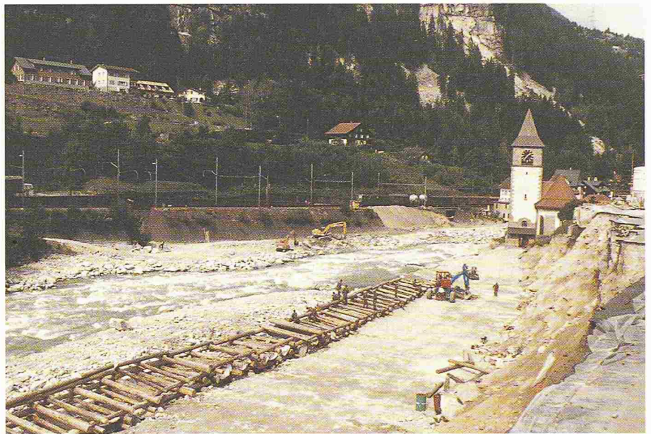
Bild 4. Kirche Gurtellen, im Vordergrund zerstörte Gotthardstrasse, Bau von Krainerwänden (Foto Bauamt Uri)
