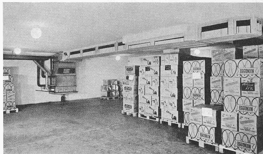
Bild 4. Blick in einen Eierlagerraum mit Kaltluftkanal an der Decke und Luftkühler an der Rückwand. Die Frischluft-Zufuhrleitung tritt von links unten in das Luftkühlergehäuse ein
