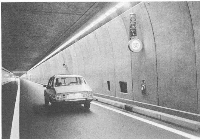
Bild 2. Beleuchtung der Mittelzone
