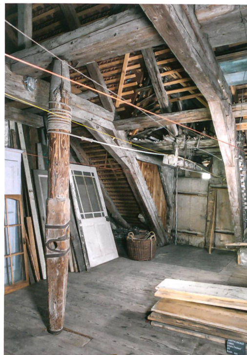
Abb. 3: Ligerz, Chlyne Twann 7. Dachgeschoss. Der Aufzugsgiebel wurde zusammen mit dem Dachstuhl gebaut. Links im Bild ist die originale Winde zu sehen, mit deren Hilfe die Lasten unters Dach befördert werden. Blick nach Südosten.
