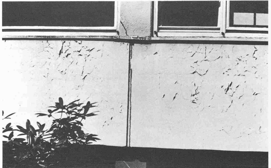
Durch Bindemittelanreicherung in der Oberfläche und unterschiedliche Ausdehnungskoeffizienten von Beton und Oberfläche (Sinterhaut) entstehen Risse, die durch einen normalen Anstrich durchgehen und zu Ablösungen führen
