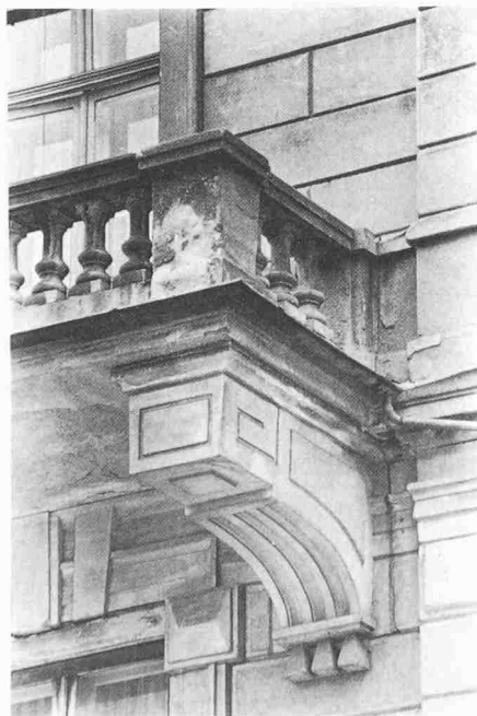
Verwitterungsschäden an Balkonen
