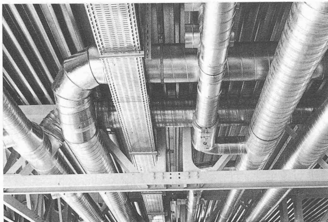
Bild 1. Beispiele von Installationen
