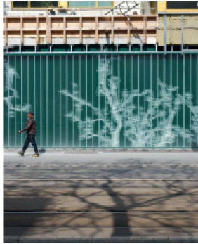
Profilglasfassade des Sockelgeschosses an der Badenerstrasse. Da die Montage der vorgehängten Fassadenelemente aus Glasfaserbeton im Obergeschoss noch nicht abgeschlossen ist, haben wir auf dem Titelfoto ein paar fehlende Platten eingefügt (Foto: af/Red.)
