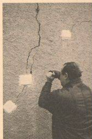
Schäden können mit einer Sofortbildkamera jederzeit festgehalten werden, ohne dass die Bauarbeiten unterbrochen werden müssen. Die Fotos werden auch von Versicherungen als Beweismittel akzeptiert
