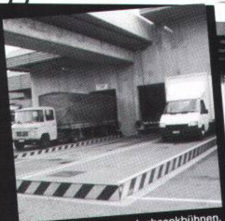
z.B. Lastwagenhub- und -absenkbühnen, auf Strassenniveau überfahrbar.
