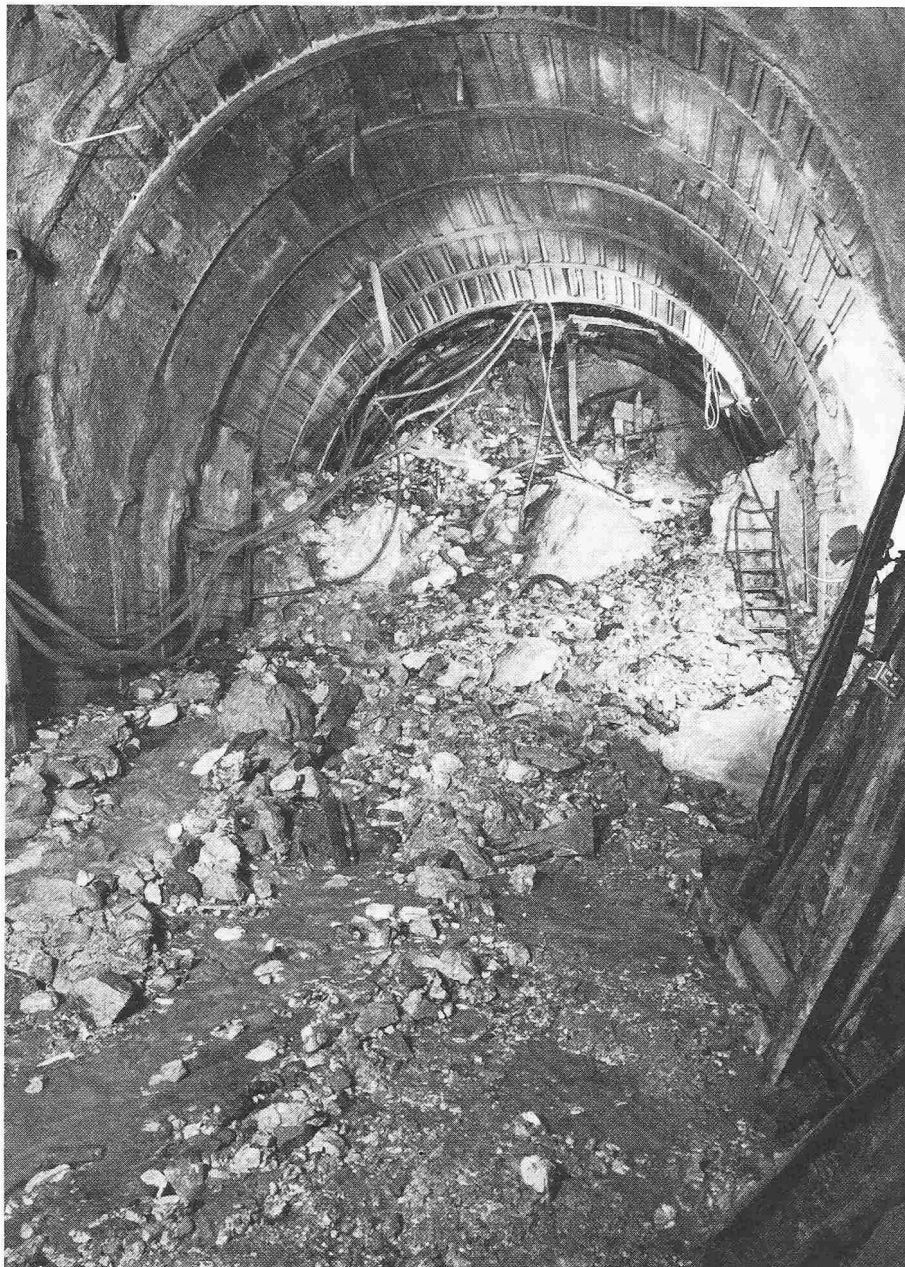
TM 3380: Einbruch von Wasser, Schlamm und Gestein im Bereich des Rotondogranits (29. Juni 1977). Die Vortriebsarbeiten wurden um sechs Monate verzögert
