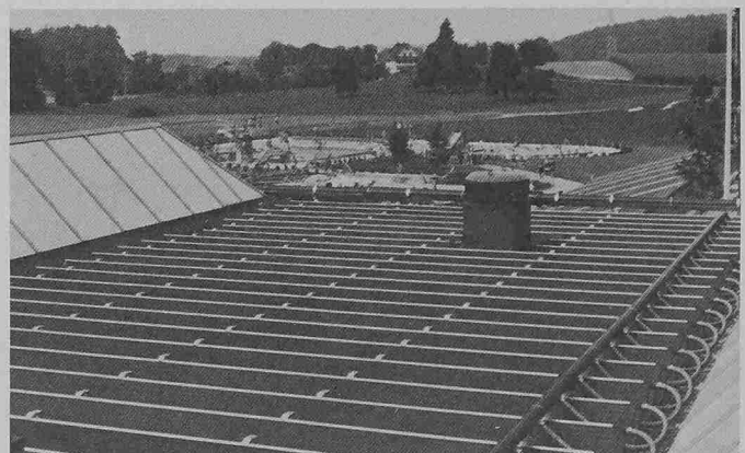
Auf dem Turnhallendach verlegte Niedertemperatur-Kunststoffkollektoren Sessa Exro erwärmen direkt das Schwimmbadwasser der Freibadanlage Bachmatten in Muri (AG)
