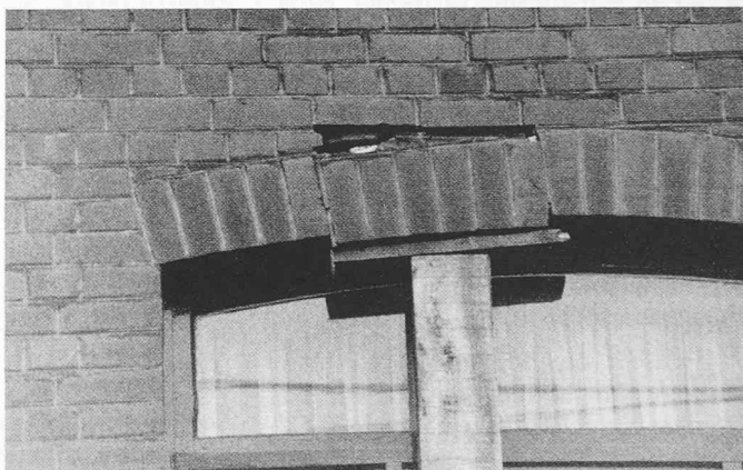
Bild 10. Nach unten verschobener Teil eines Fensterbogens. Deutet auf starke vertikale Beanspruchung hin
