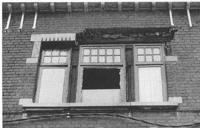
Bild 7. Herausgebrochene Fenstereinfassungen an einem Haus in Saint-Nicolas. Das Zweischalen-Mauerwerk wird sichtbar, wobei die innere Schale qualitativ schlechter scheint als die äussere Schale
