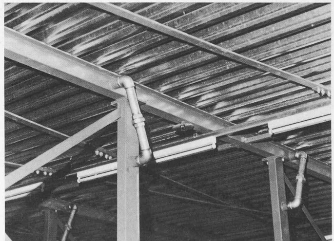
Bild 5b. Rohrverbindung von den wasserführenden Vertikal-Rahmen zu den Dachträgern (Werkphoto Total Walther Feuerschutz GmbH, Köln)
