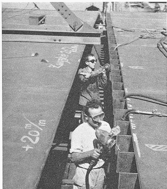
Bild 25. Bearbeiten eines Passtosses zum Ausgleich der Schrumpfung der Schweißung der Montagestumpfstösse der orthotropen Platte. Solche Passtösse wurden alle drei bis vier Platten angeordnet. Montagefortgang von rechts nach links. Beim Plattenstück links ist ein Teil der Aufhängevorrichtung zum Versetzen sichtbar
