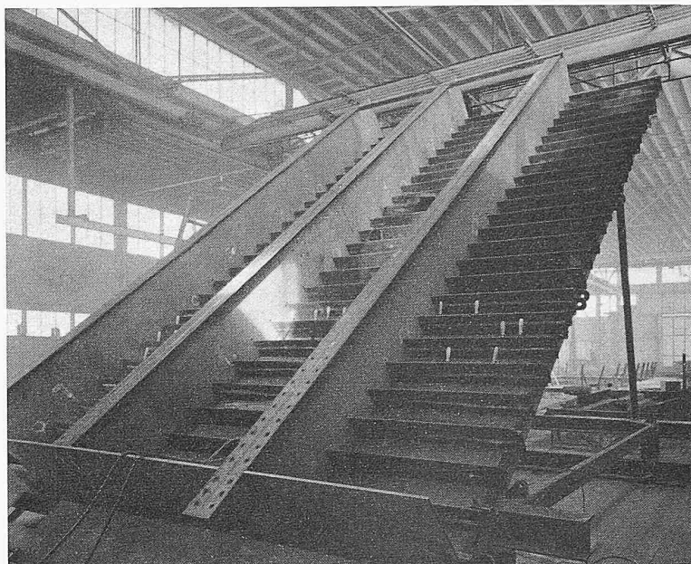
Bild 26. Orthotrope Platte in der Werkstätte, gesehen von unten (Die hellen Stücke sind die Holzgriffe der Kupferschienen für die Schweißung). Grösse des Stückes 5 \times 8 m. Nach dem Umdrehen werden zwei solche Stücke vor dem Transport auf die Baustelle zu einer Tafel von 5 \times 16 m zusammengeschweisst
