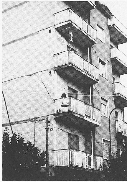
Bild 17. Klaffende Risse an einem Stahlbetonskelettbau in S. Michele di Serino bei Intensität VIII
