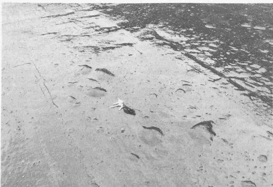
Bild 3. Blasen unter einer kunststoffmodifizierten Bitumenfolie
