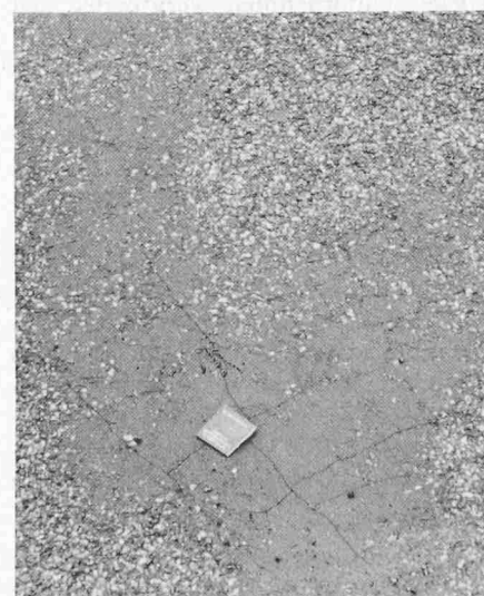
Bild 6. Durch eine weiche, dicke Abdichtung wurde dieser Gussasphalt schon im ersten Winter zerstört
