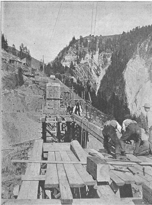
Abb. 31. Schliessen der vorgebauten Teile des Lehrgerüsts über der Mittelöffnung. — Erbauer Zimmermeister R. Coray in Trins.
