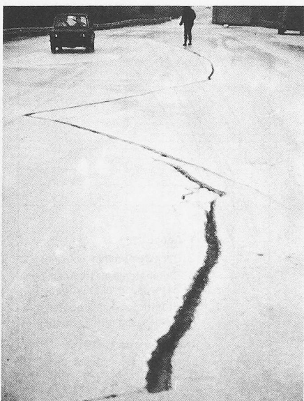
Bild 27. Abrutschen der Dammböschung an der im Bau befindlichen Strasse von Lioni nach Nusco
