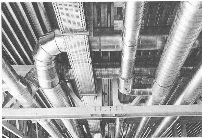
Bild 1. Beispiele von Installationen
