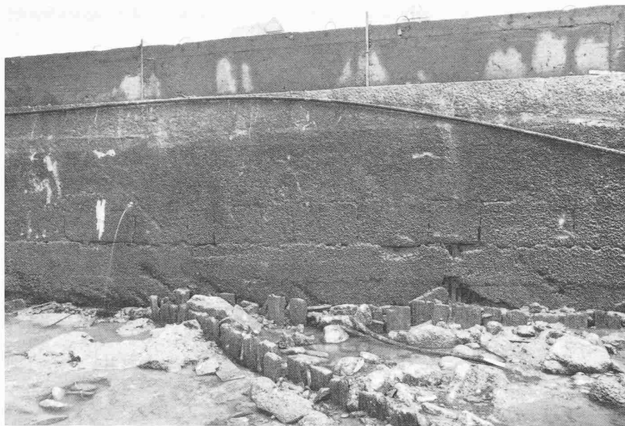
Spundwand von 1818 am Bälliz-Zinggen mit Wasserdurchtritten von der inneren Aare
