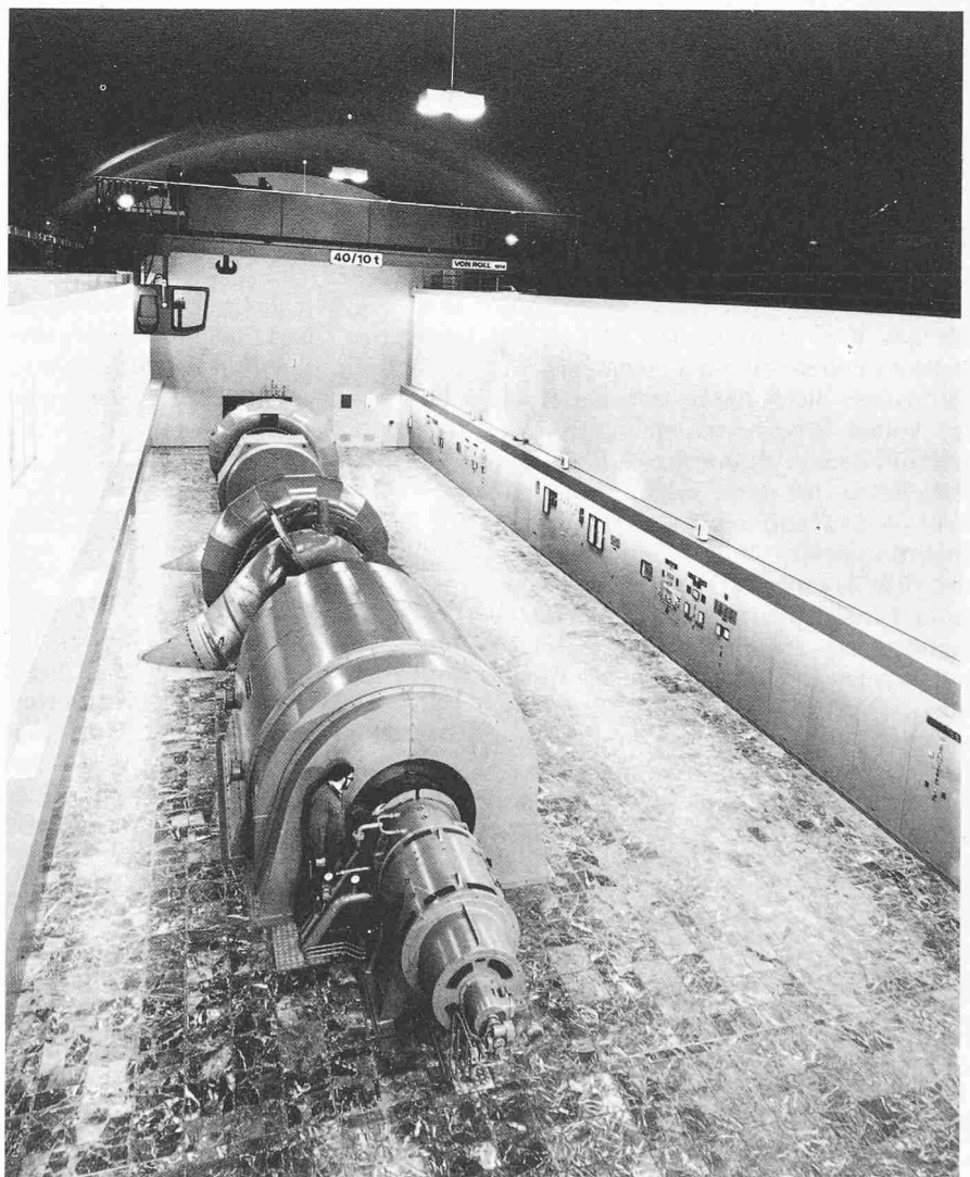
Bild 7. Maschinensaal im fertigen Zustand. Im Vordergrund: Maschinengruppe Isogyre. Im Hintergrund: Regulierbare Pumpe mit Antriebsmotor. Rechts: Steuertafeln für die örtliche Steuerung
