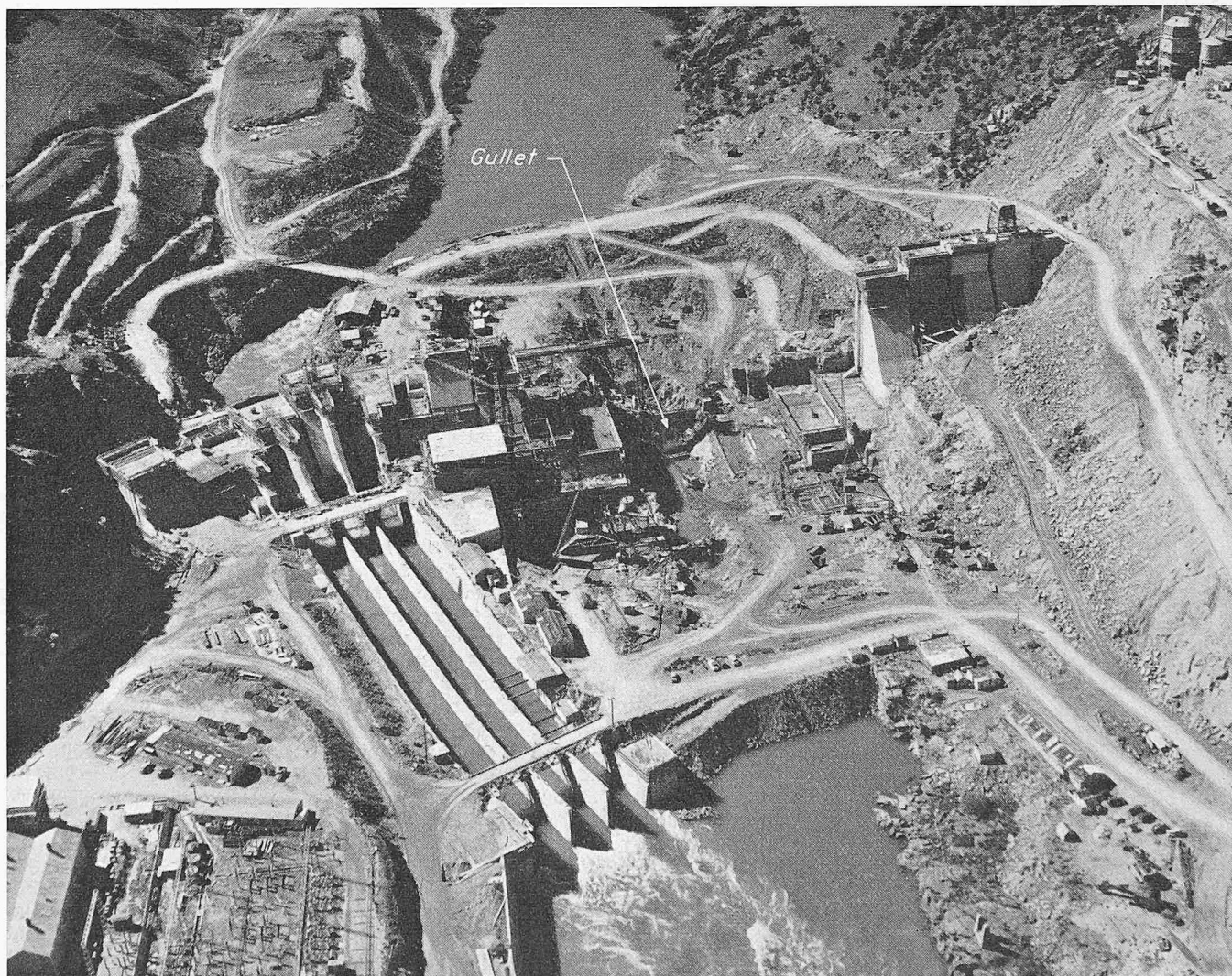
Bild 3. Flugbild der Baustelle (Gullet bezeichnet die tiefste Zone der Erosionsrinne)
