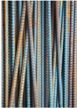
Angerostete Bewehrungsstäbe (KEYSTONE/CARO/Felipe Rodriguez)
