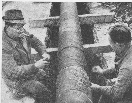
Bild 3. Die Stosstellen werden nach Verlegung zusammengeschweisst und mit «Vetrotex»-Band isoliert (Gaswerk Zürich)
