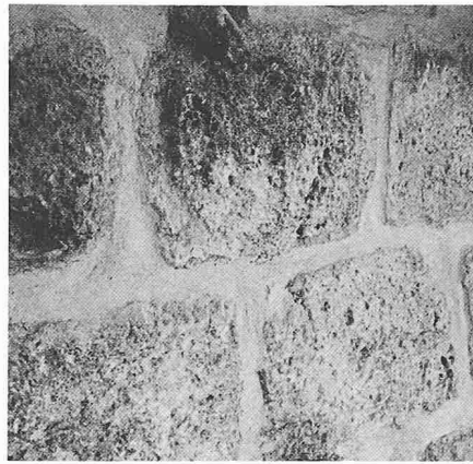
Bild 5. Gesundes Quadermauerwerk sollte nicht verputzt werden. Der Fugenmörtel muss aber rissfrei an die Steinflächen anschliessen
