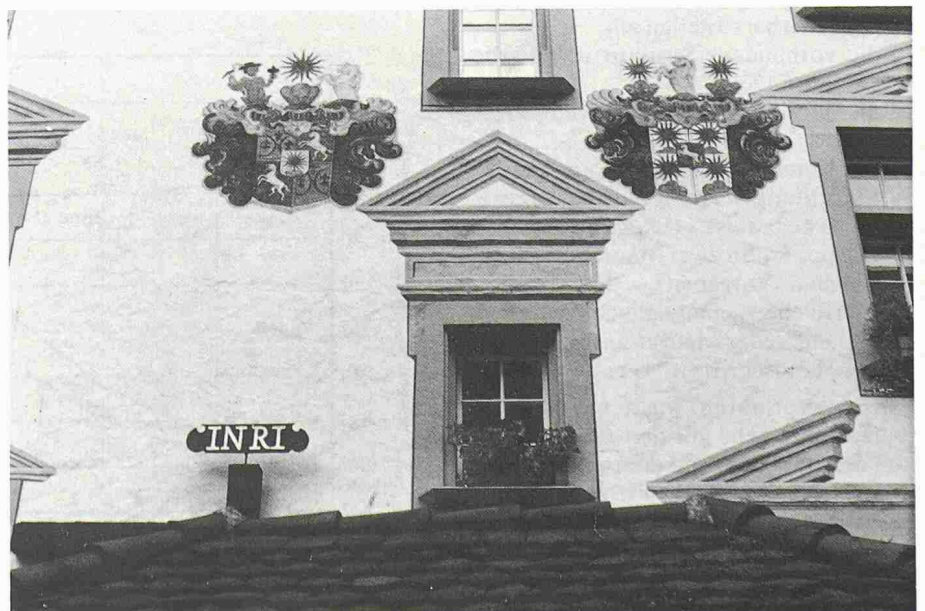
Bild 4. Vermutlich wurde hier der Grundputz mit der Kelle dressiert (geglättet), Haus zur Liebenau, Luzern
