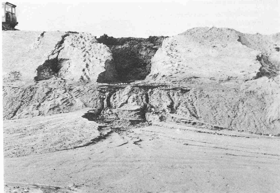
Bild 12. Kerzers N1. Starke Niederschläge verursachten tiefe Erosionsrinnen in den angeschnittenen Böschungen
