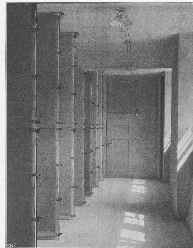
Abb. 11. Filterkammer im Hadwigschulhaus St. Gallen.
