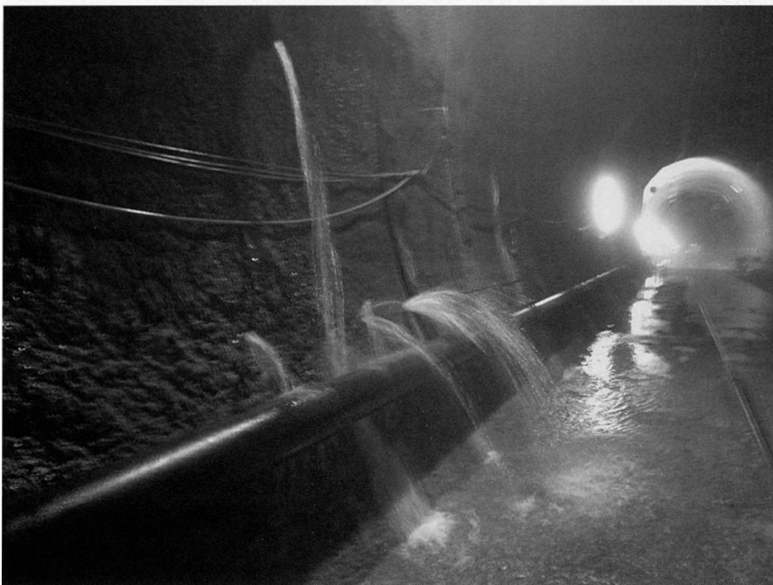
Fig. 1: Ergiebige Bergwasserzutritte in der Weströhre im Bereich des Querschlages 16 während der Schneeschmelze. Bild vom 21.6.2010 bei km 204.735, Blick Richtung Süden.
