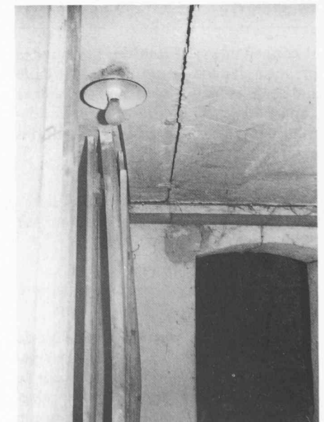
Fig. 4. Déformation des cloisons de séparation et fissuration au plafond d'une des caves
