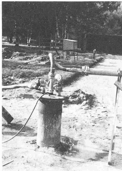
Bild 11. Filterbrunnen zur Grundwasserdruckentlastung mit aufgesetztem Kopf für Vacuumhilfe
