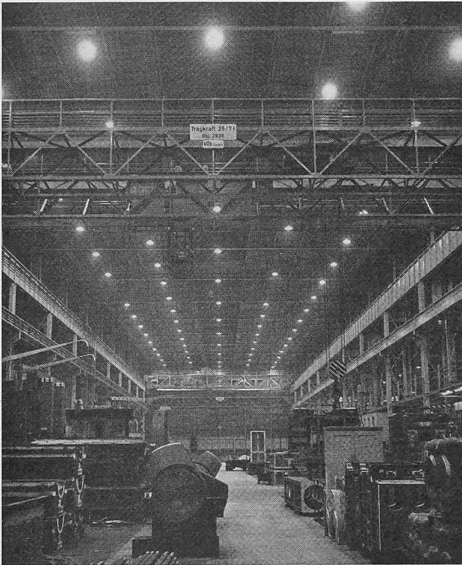
Bild 19. Beleuchtung der Grossbearbeitungshalle, bestückt mit 700-Watt-HPL-Lampen in den drei Mittelreihen und 1000-Watt-Lampen in den beiden Aussenreihen
