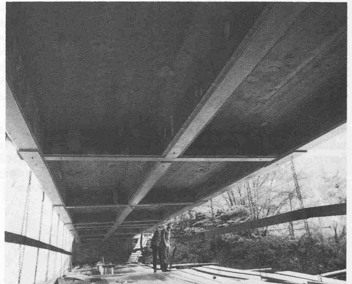
Bild 5. Gesamtansicht der Brückenunterseite mit den geklebten Verstärkungsblechen auf den Längs- und Querträgern
